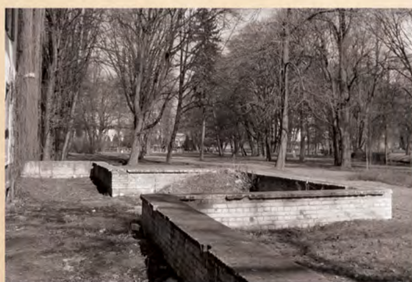
Przed rewaloryzacją: zniszczony mur i widok na plac zabaw
